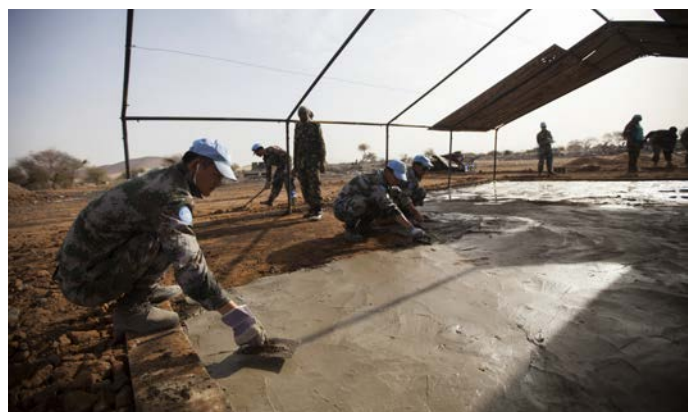
في ٧ أبريل ٢٠١٤ في خور أبشي، جنوب دارفور، مهندسو اليوناميد يعملون على تشييد مركز مجتمعي للنازحين الذين يعيشون الآن داخل مقر اليوناميد بخور أبشي. يقع هذا المركز المجتمعي وهو الثاني من نوعه داخل المنطقة الآمنة التي تبلغ مساحتها ٧٠٠٠٠ متراً مربعاً وسيحتوي المركز عند اكتماله على أبراج مراقبة، إضاءة بالطاقة الشمسية ومراحيض. تصوير ألبرت غونزاليس فران، اليوناميد.
